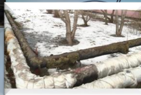
Протяженность тепловых сетей в двухтрубном исполнении 16,34 км, d 50-420мм
